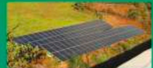
34,32 kWp - 104 módulos Saudades/SC
